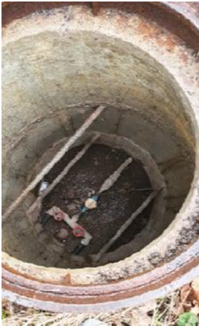
Figur 8 Exempel på ej godkänd montering av vattenmätare i mätarbrunn. Vattenmätaren är inte monterad i vattenmätarkonsol och dessutom för nära brunnen botten.
