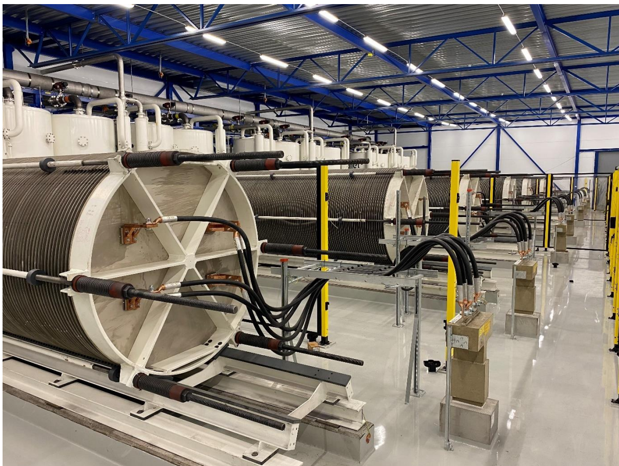
Figur 20, 6 x 2,5 MW AEL elektrolysörer installerade vid Ovako stålverk i Hofors, Sverige.
