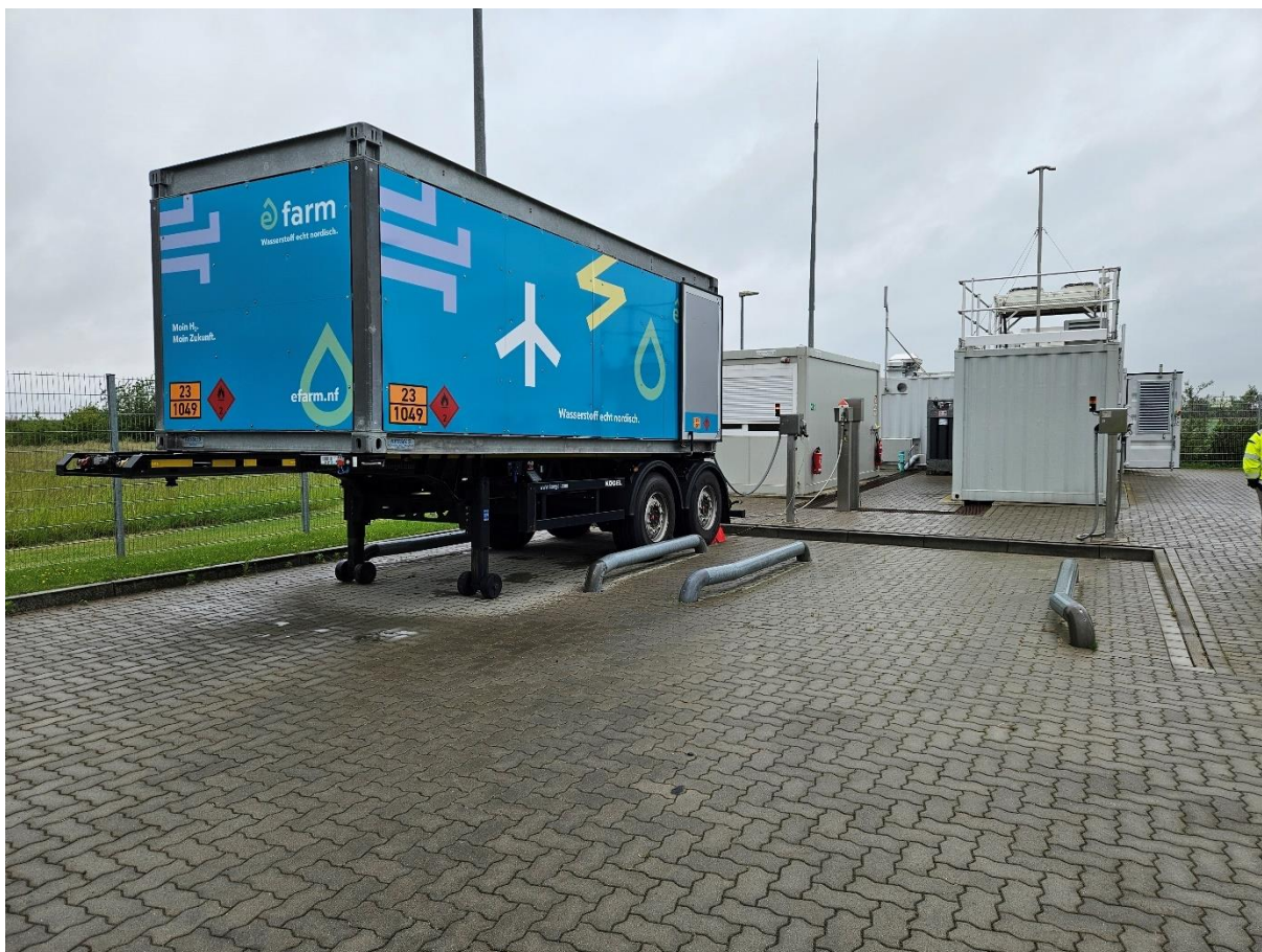
Figur 23, 20 fots tube trailer bredvid en 1 MW elektrolysinstallation vid GP Joules i Reussenköge, Tyskland.
