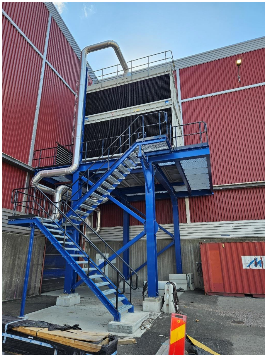
Figur 22, kylare för överskottsvärme vid Ovako, 20 MW elektrolysinstallation i Hofors, Sverige.
