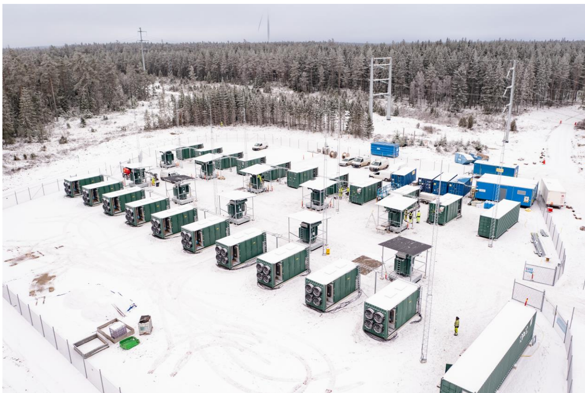
Figur 24, 42,5 MWh batterilagringsinstallation, byggt av OX2, i Bredhälla, Sverige.
